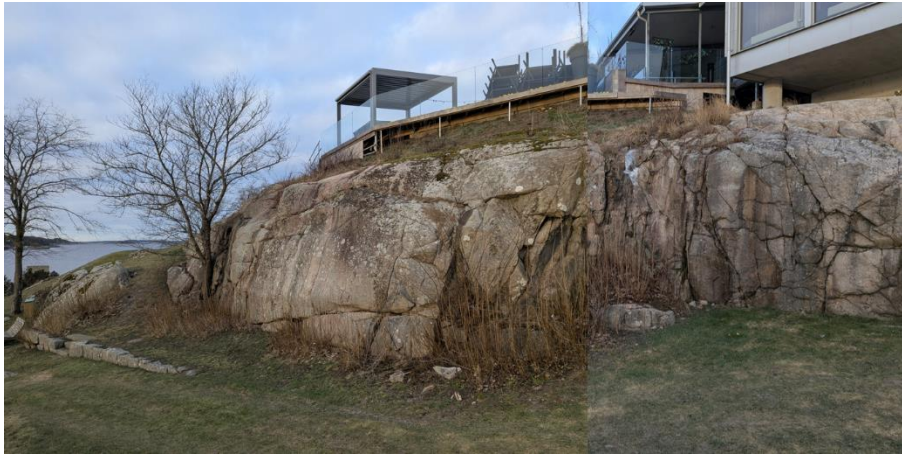
Figur 3. Uteserveringen, den sydöstra bergslänten med något tätare uppsprickning, vy mot nordväst. Stabilitetshöjande åtgärder har nyligen utförts. Det som ser ut som utfallna block är ditlagda betongklumpar.
