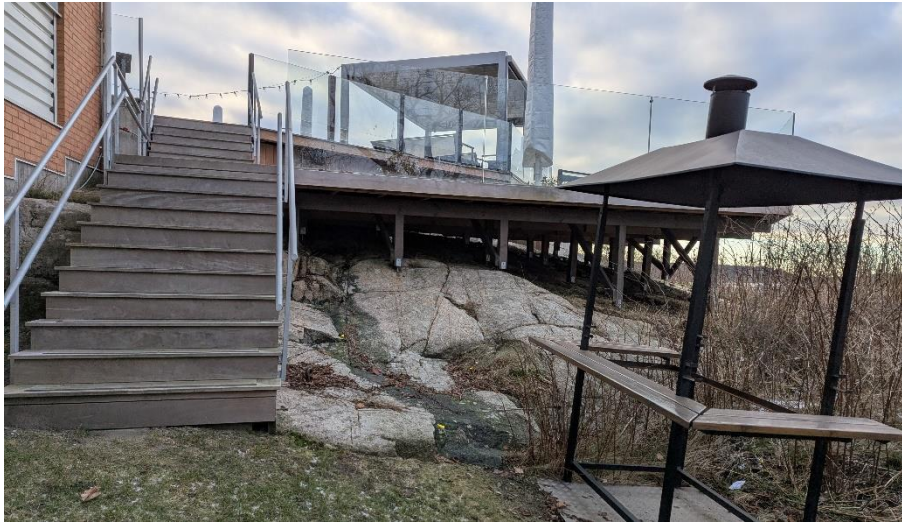
Figur 5. Uteserveringen, detaljbild av flackt lutande bergyta under trädäck, vy mot sydöst. Bergytan är stabil.
